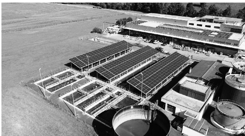
Die Schrägdachkonstruktion mit Photovoltaikanlage über den Nachklärbecken aus der Vogelperspektive
